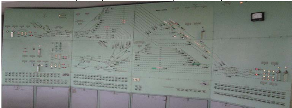
Рис. 3 – Пост електричної централізації станції Київ-Волинський
