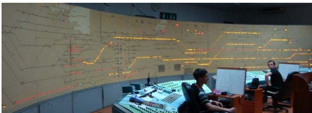
Рис. 5 – Пост електричної централізації станції Харків-Пасажирський
