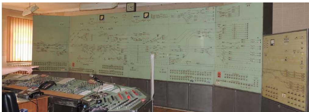
Рис. 4 – Пост електричної централізації станції Львів
